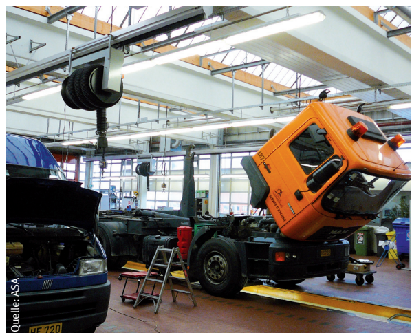
Bild rechts: Saugschlitzkanal-Anlage in der Lkw-Werkstatt
